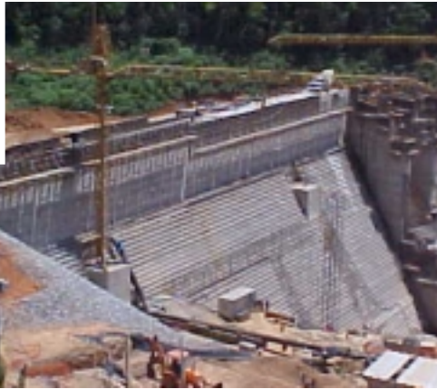
Barragem e Geradores da PCH Ormeo Junqueira Botelho
